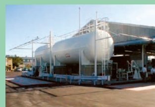
LPガス充填所
